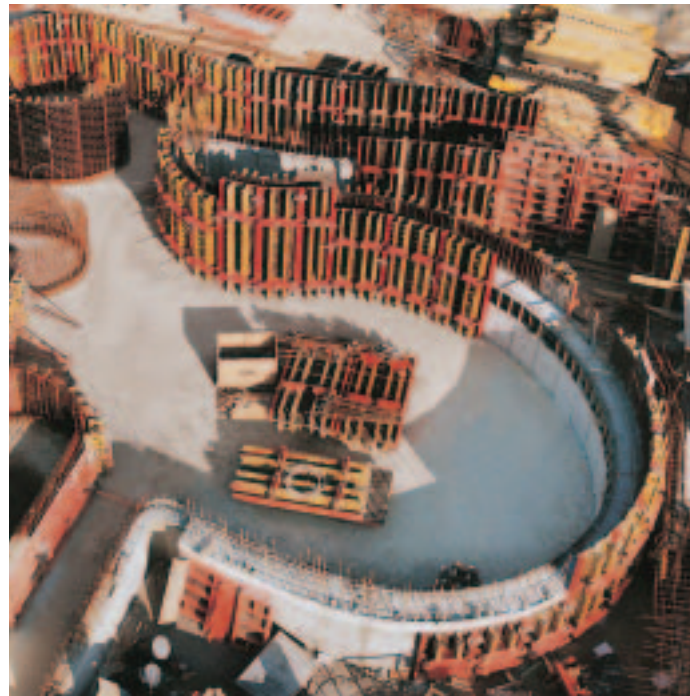
"РУНДФЛЕКС" при строителството на увеселителна къпалня - бързо кофриране при радиуси от 1,50 м до над 20,00 м.
